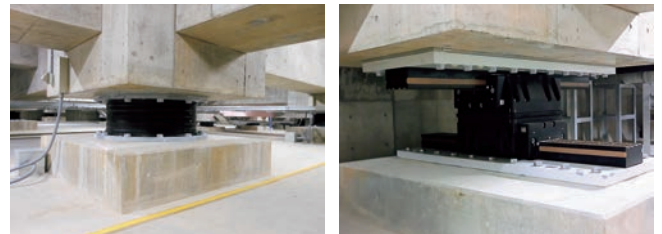
鉛直方向・水平方向の揺れを低減する免震装置
