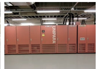
無停電電源装置(UPS)
