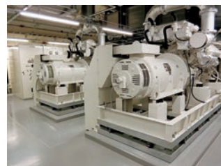
非常用発電機
